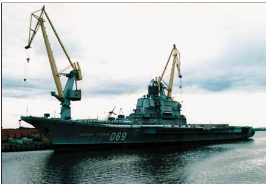
Ремонт и модернизация тяжелого авианесущего крейсера «Адмирал Горшков» — новый заказ для специалистов «Севмаша»
