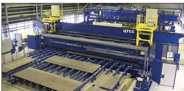
Рис. 4. Комплекс оборудования для лазерной резки и гибридной лазерно-дуговой сварки плоских секций
